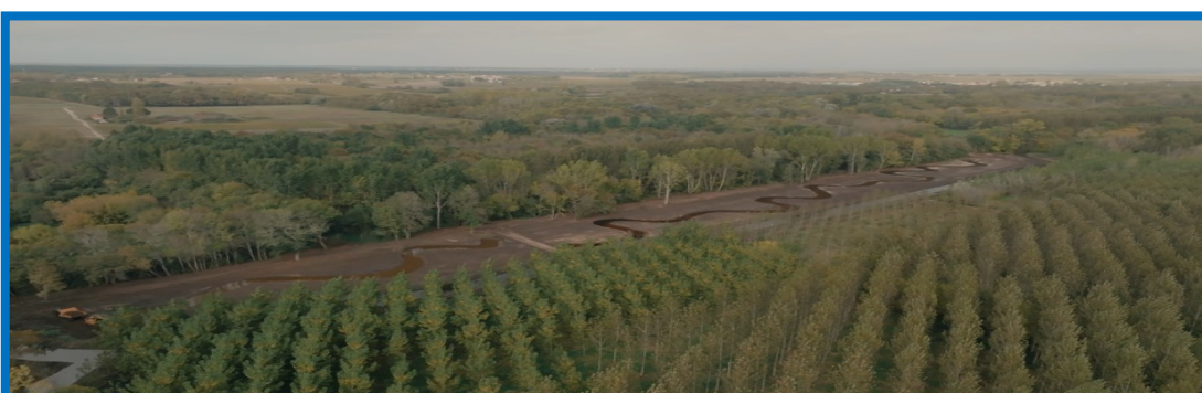
Projet de reméandrage en cours de terrassement - Crédit photo : GreenCap Studio / Equo Vivo
